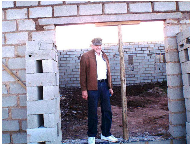
Jim no hospital em construção. A parede de trás foi a que caiu, matando 2 estudantes.
